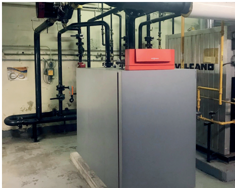
École Saint-Sauveur : nouvelle chaudière
